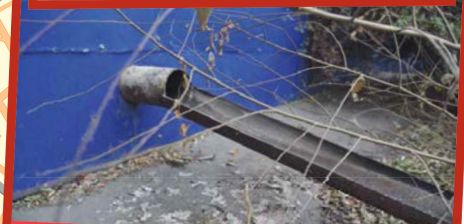
Кто-то из жильцов врезал канализационную трубу дома в канаву для ливневки, но, кроме штрафа, ему ничего не грозит
